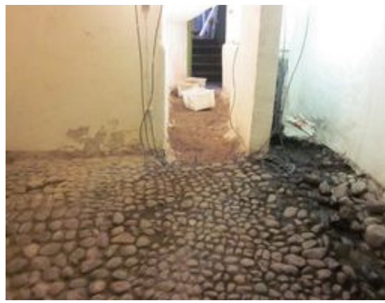
Illustration 6: Mittenrummet, samt passage under trapphus. Trappan ut mot bakgården syns i bakgrunden. Vy mot öst.
